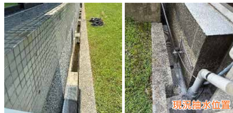
原有抽水馬達保留，在室內施作一道排水管通往戶外(排水管外觀會封起來)
